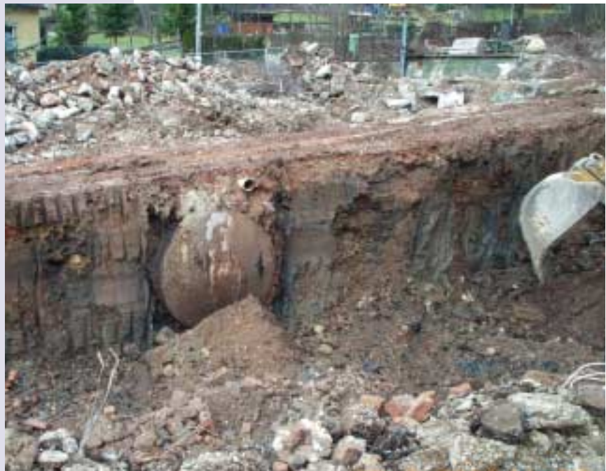
Instalación de tanques subterráneos. Focos de ingreso de sustancias nocivas al suelo y aguas subterráneas
