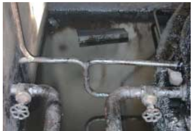
Área en sospecha "tanque de gasóleo en el edificio de lavandería y calefacción"
