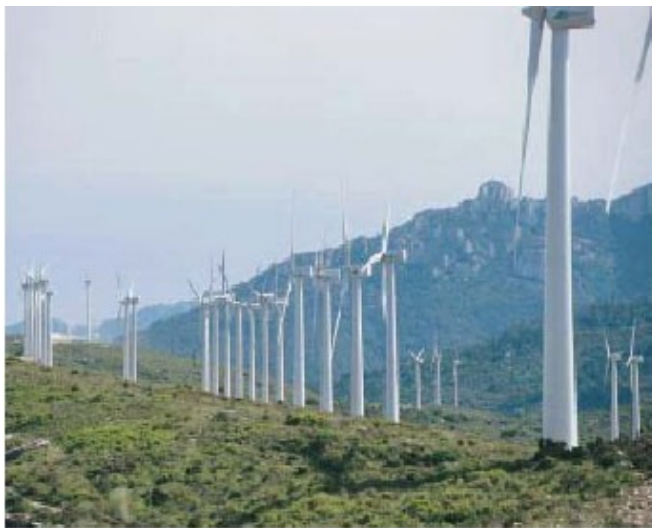
Parque eólico Trocafort
